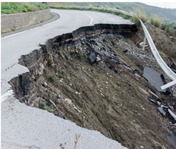
Glissement, Adobe Stock
