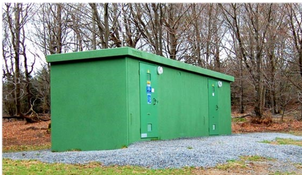
Un exemple de poste de livraison électrique
