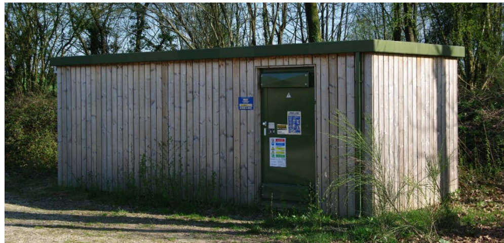
Figure 14 : Type de poste de livraison (source : Pierre-Yves Hagneré, 2017)
