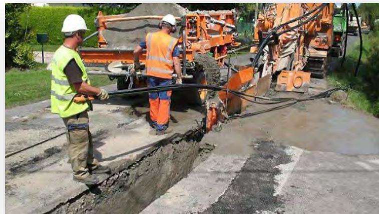
Figure 171 : Illustration d'un passage de câbles électriques sous voirie (Source : La Voix du Nord, Ouest France)
