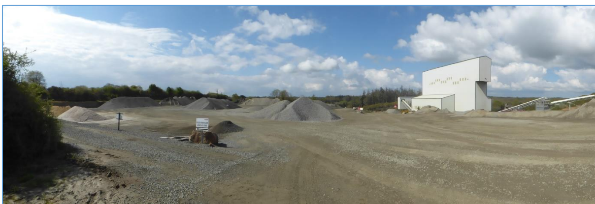
Fig. 33 : Vue n°4 : Installations de traitement secondaires et tertiaires, aire de stockage
