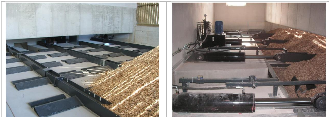
Figure 3 : Photographies d'échelles à fond racleur et des vérins hydrauliques (Source SB Thermique)
