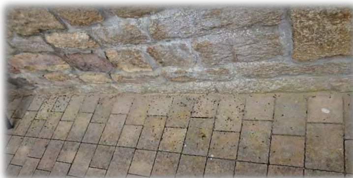
Photo 7: Guano sur la terrasse
