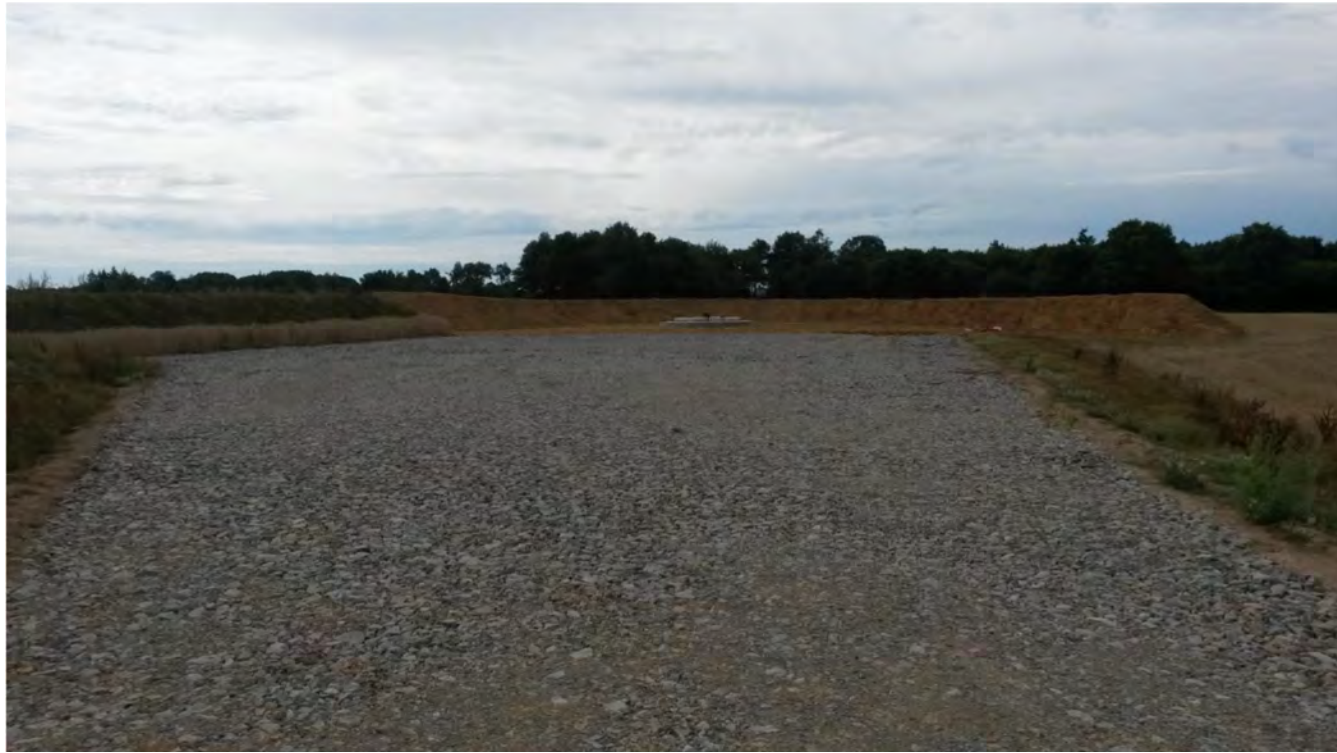
Illustration 107: Exemple de plateforme de grutage
