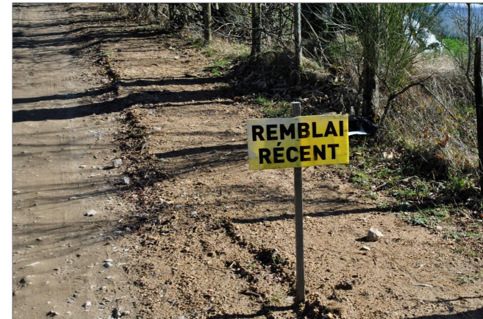
Photographie 34 : Exemple de remblai des tranchées électriques le long d'une piste (Source : ENCIS Environnement)
