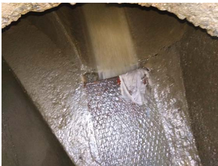
photo 1 : exemple de DO « lumière » - DO Pont de Belle Isle
