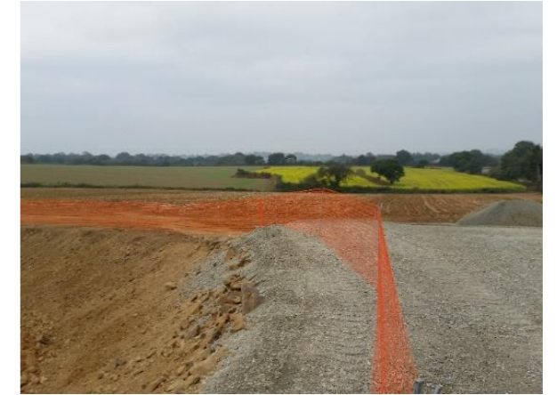
Photo 50 – Autre exemple de filet de chantier.
