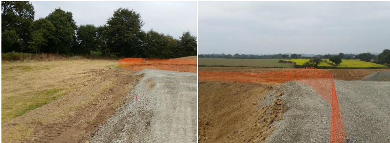
Exemple de filet de chantier permettant de délimiter des emprises au sol Autre exemple filet de chantier (Source : Synergis environnement)
