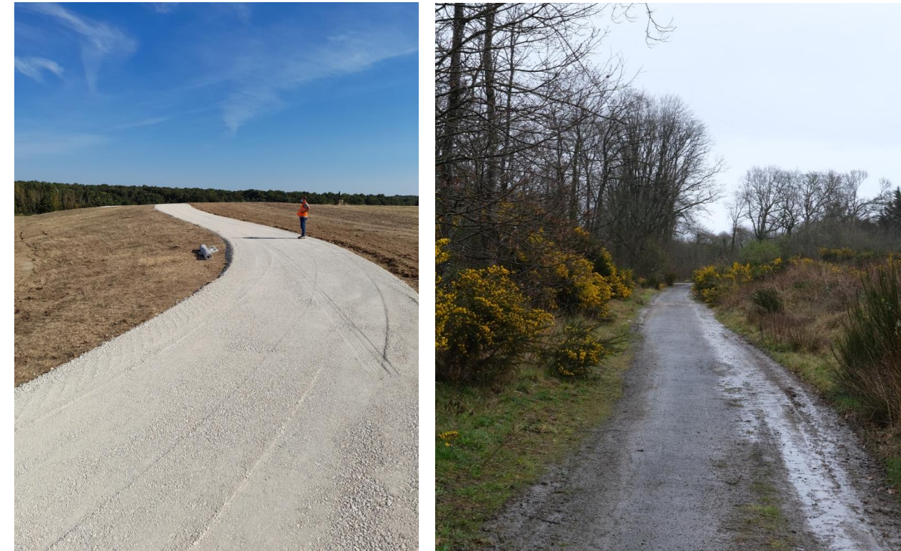
Figure 7 : Voie périphérique de la centrale photovoltaïque de Vendôme (une réalisation IEL) (gauche), Photo de la voie existante sur le site d'Aucaleuc (droite)
