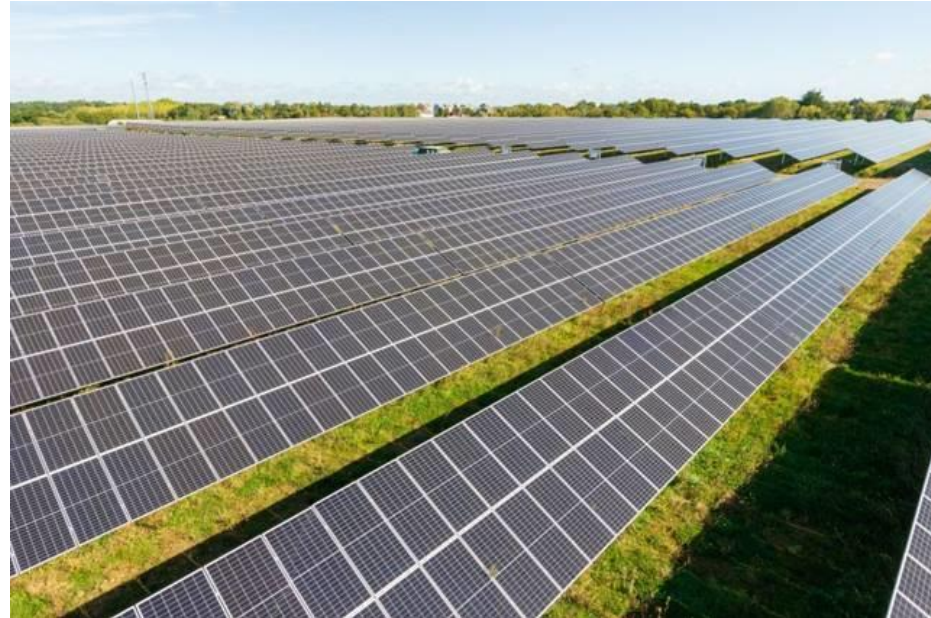
Figure 6 : illustration de l'espacement entre les rangées de panneaux photovoltaïques (FS Marc Energies, une réalisation IEL)
