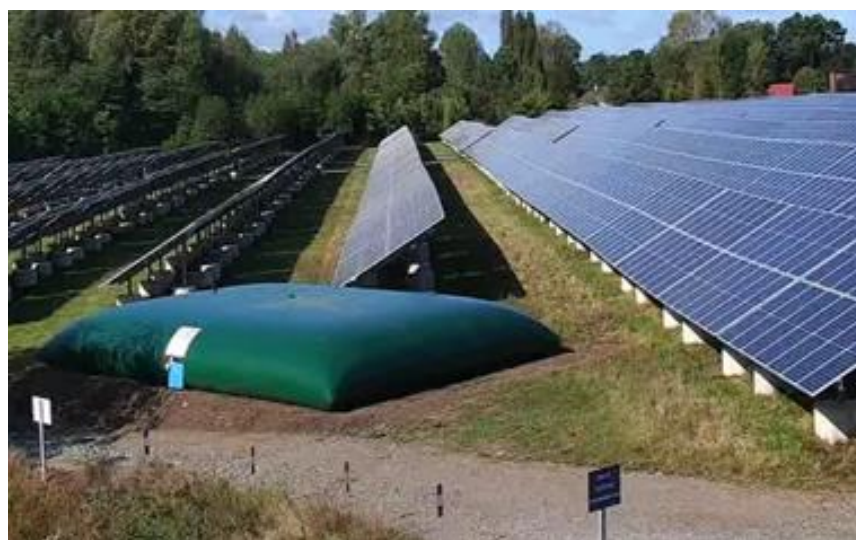
Figure 20 : Citerne incendie 60 m3 de la centrale photovoltaïque au sol du Gravier à Aubigné-Racan (72), une réalisation IEL
