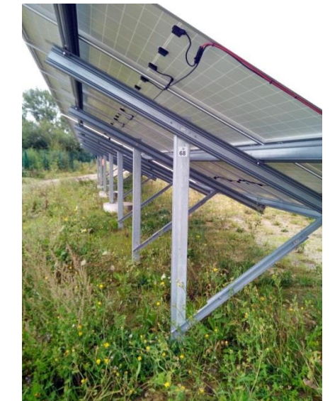
Figure 29 : Câblage intégré aux structures (Bruz)
