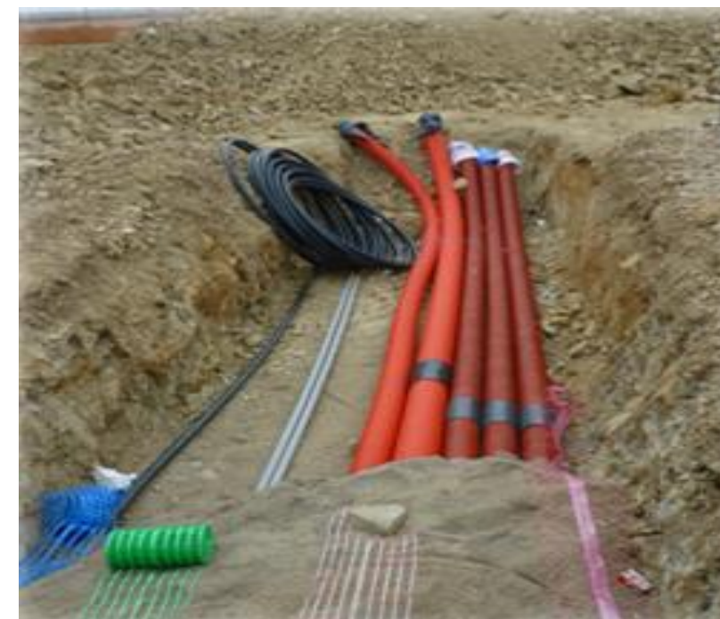
Figure 34 : Câblage sur site entre les postes électriques (source : IEL)
