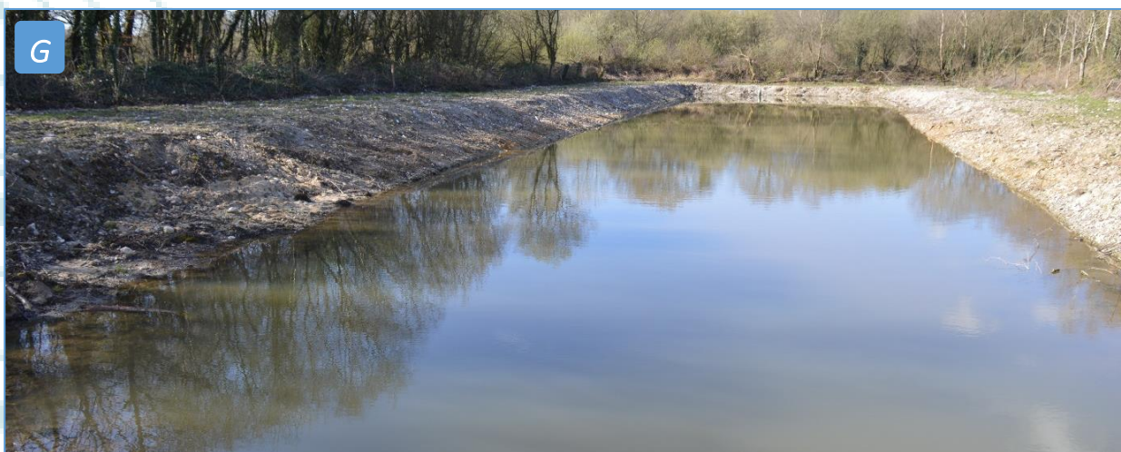
Fig. 26 : Bassin terminal de décantation
